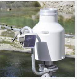
Unité RTU avec panneaux solaires fixés sur le pied du pluviomètre
